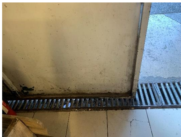
Slika 12. nedostatak mreže ispod vrata skladišta
