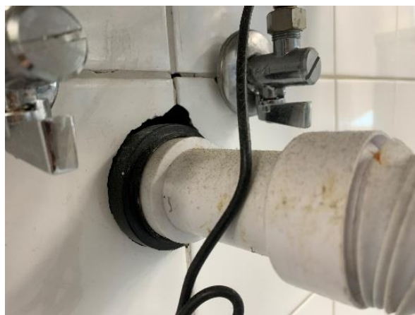
Slika 11. oštećenje oko sifona u kuhinji
