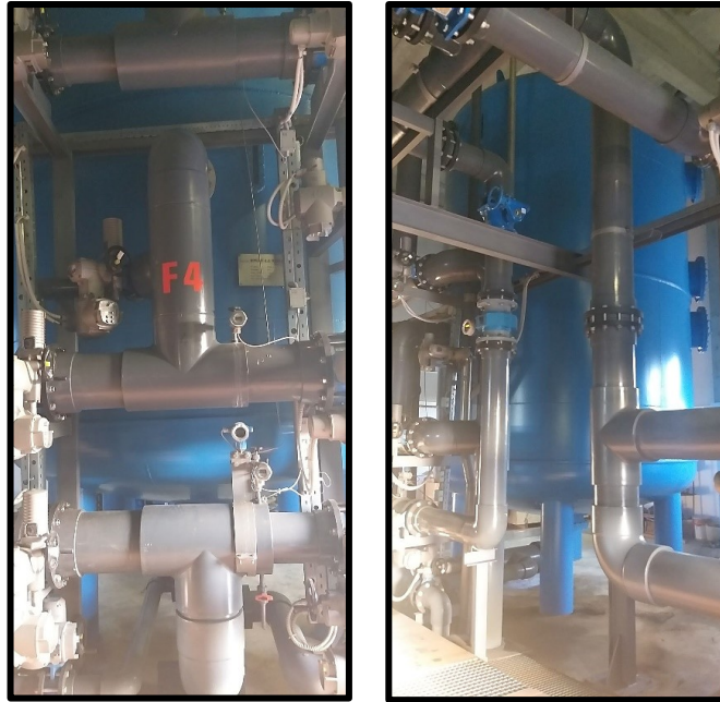
Slika 16. Višeslojni filteri za obradu vode na vodozahvatu Vela Fontana
