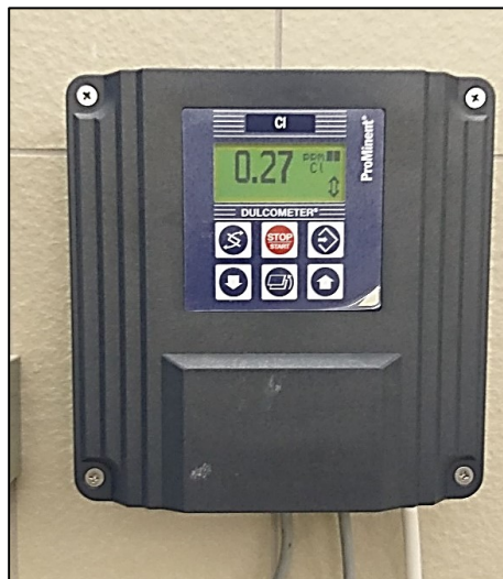
Slika 19. Uređaj za očitavanje rezidualnog klora
