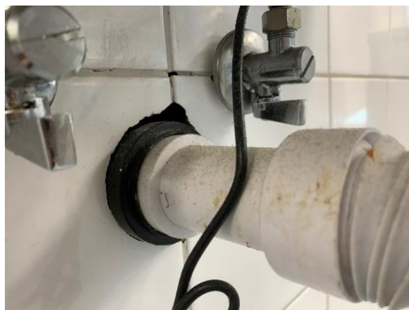
Slika 11. oštećenje oko sifona u kuhinji
