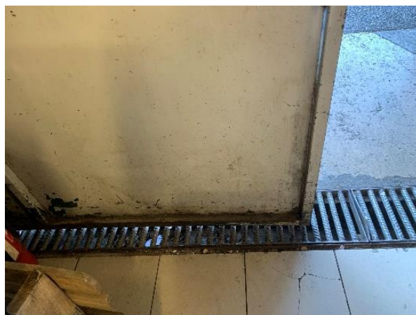
Slika 12. nedostatak mreže ispod vrata skladišta
