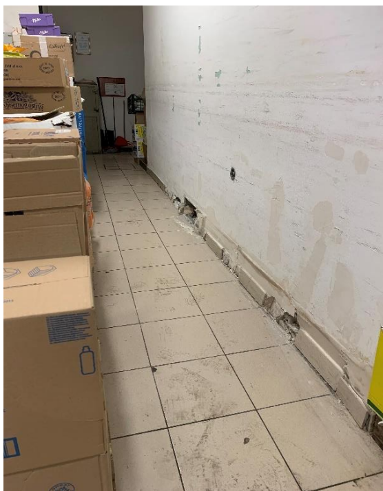
Slika 10. Oštećenje zida/poda između skladišta i hodnika
