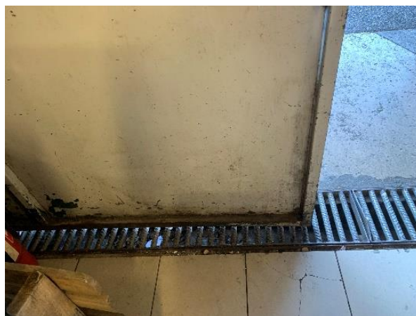
Slika 12. nedostatak mreže ispod vrata skladišta
