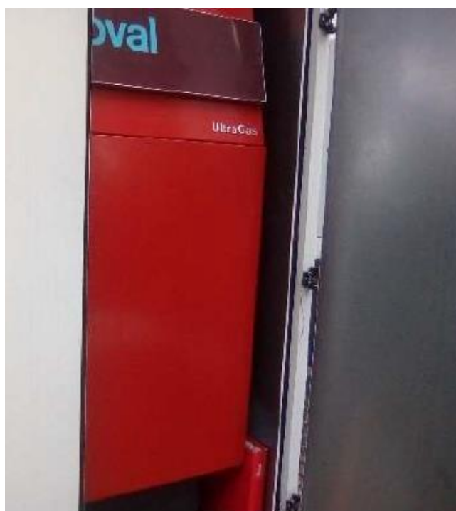
Slika 11. Plinski kondenzacijski kotao proizvođača Hoval, tip Ultra GAS-400
