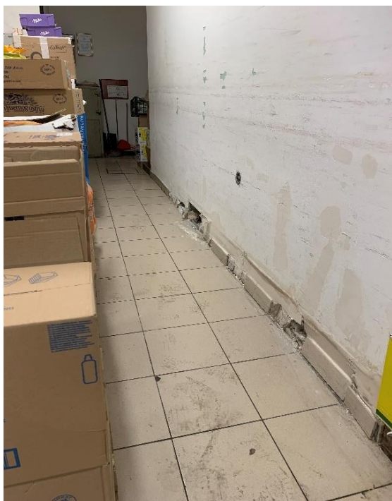
Slika 10. Oštećenje zida/poda između skladišta i hodnika
