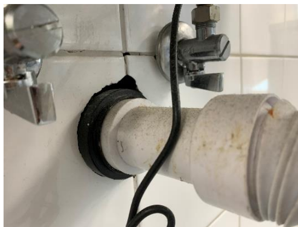
Slika 11. oštećenje oko sifona u kuhinji
